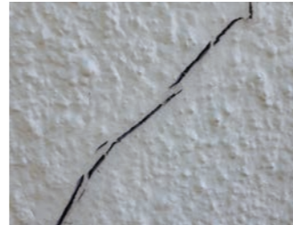
Lézardes DTU 20.1, pour les maçons
