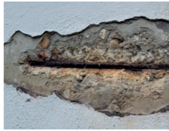
Éclats de béton
